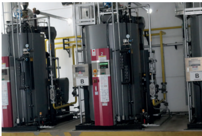
Caldeiras novas miura movido a gás GLP na Matriz
